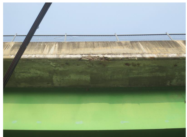
바닥판 파손 S3
