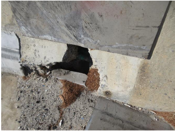
방호벽 파손 S3
