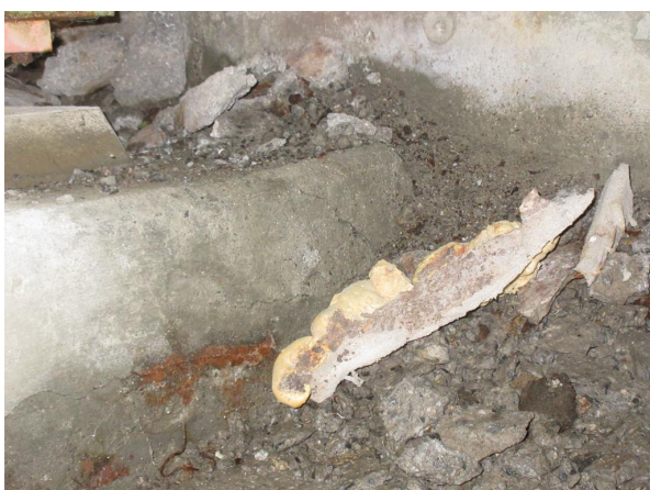
받침콘크리트 파손 A1-SH1
