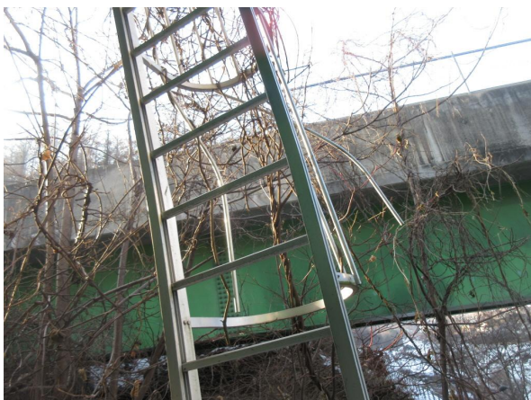
점검사다리 난간 파손 A1
