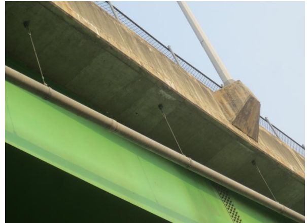
좌측 캔틸레버 상태양호 S2
